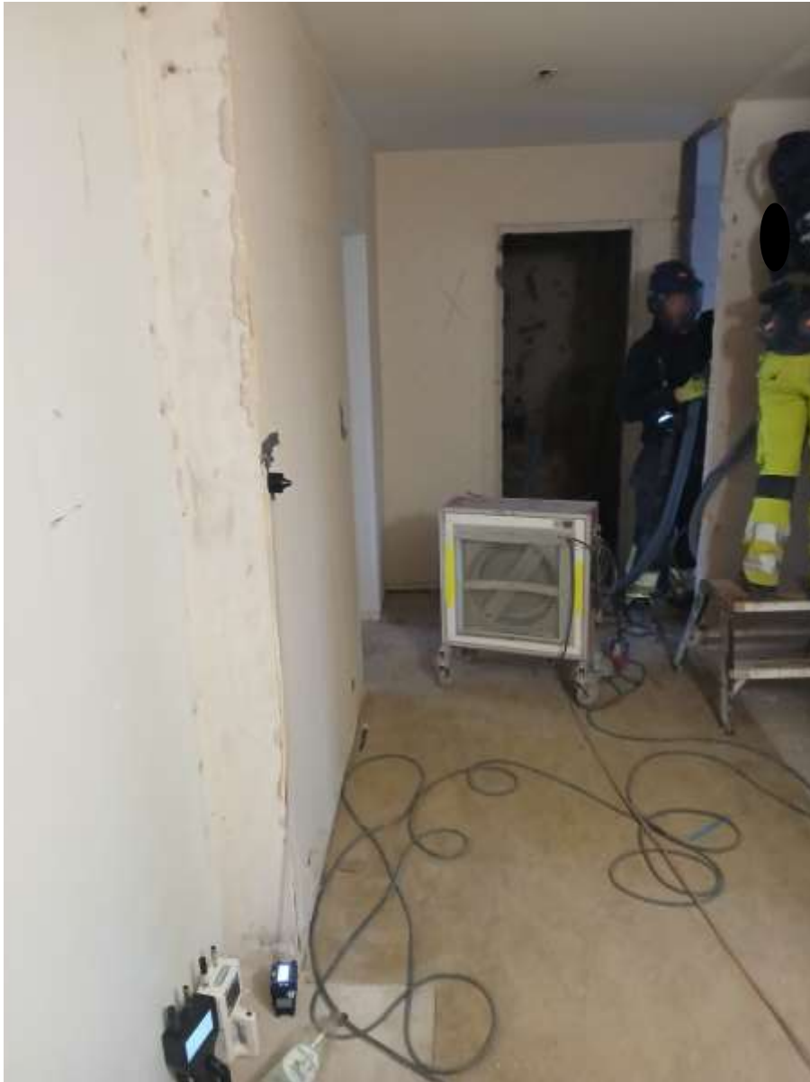
Bild 5. Arbete med demontering av lättbetongväggar i badrum. Bild visar operatörer i arbete men där placering av partikelräknare samt provtagare i entréhallen syns.
